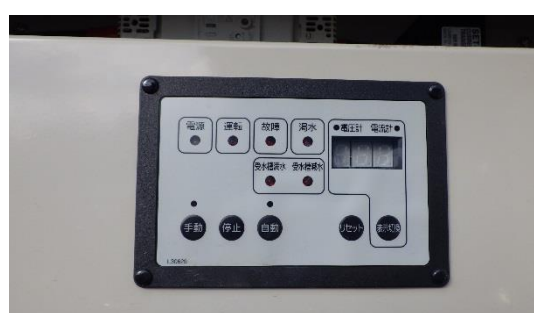
〔配電盤の中 拡大写真〕
