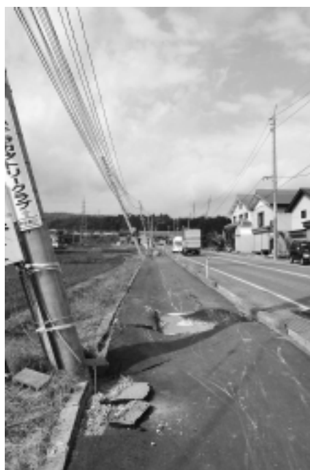
大きく傾いた電柱
