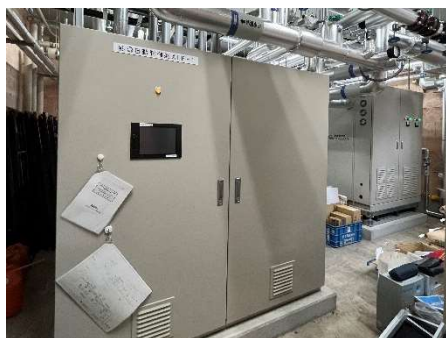
錦鯉の里の地中熱ヒートポンプ
