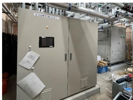
錦鯉の里の地中熱ヒートポンプ
