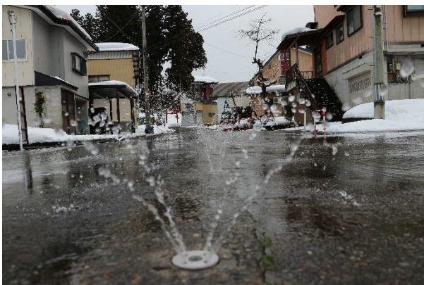
1月25日 整備された消雪パイプ
