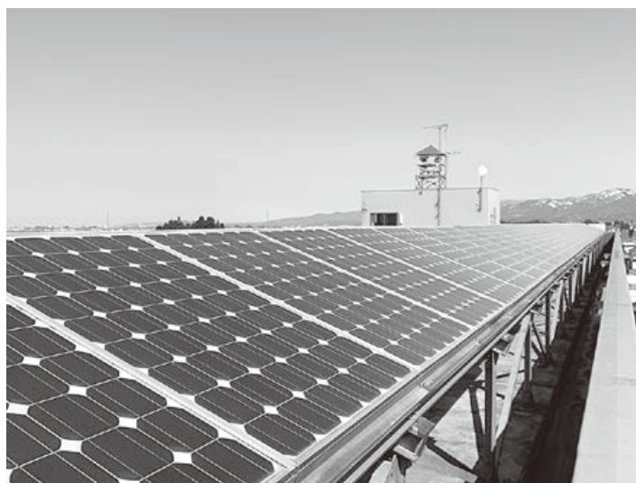
片貝総合センターに設置されている太陽光発電パネル
