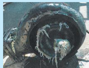
△タオルが絡まって停止した汚水ポンプ
