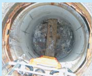
△油で詰まったマンホール内
