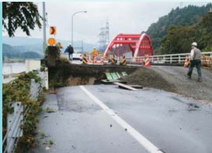
段差ができた山辺橋
