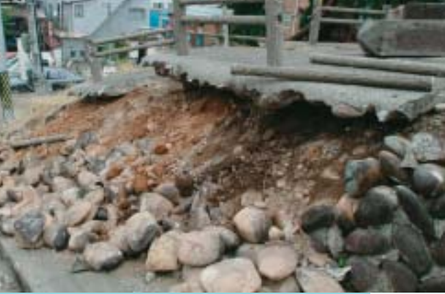
崩れた石垣 - 稲荷町
