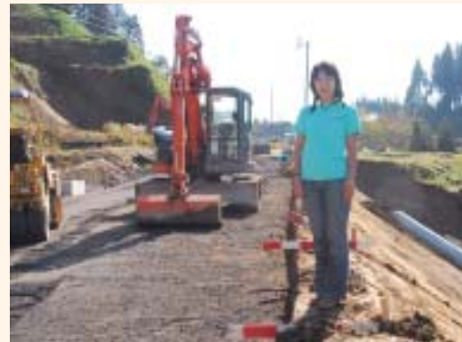
現在も復旧工事が続く県道小千谷大和線
