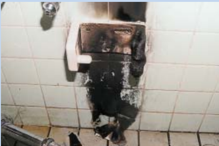
トイレトパーパーに放火されたトイレ
