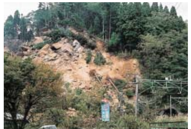
大規模土砂崩れにより浦柄・東山への道路は通行 止めに
