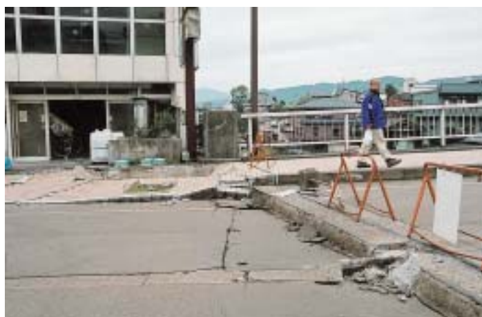
サンプラザ通りも道路に段差
