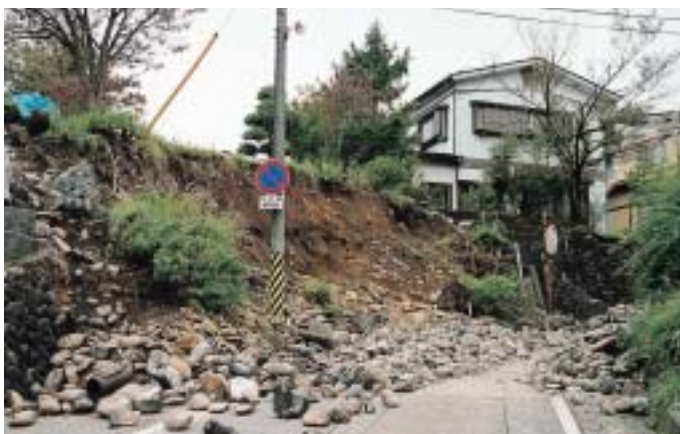
石垣が崩れる坂(稲荷町)
