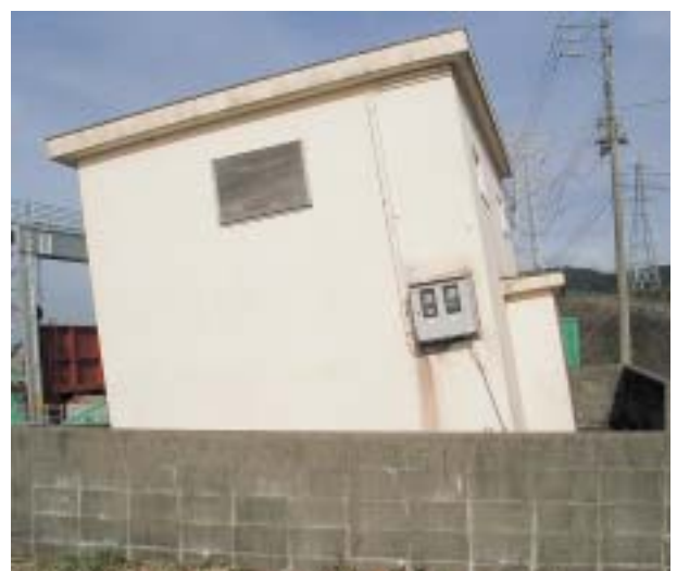
被害を受ける水道施設（山本第2ポンプ場）
