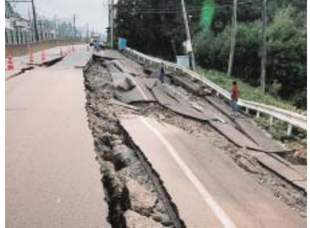
陥没する道路（蕪生地内）
