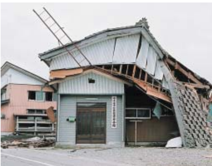
崩壊した小千谷市公民館吉谷分館（滝谷）
