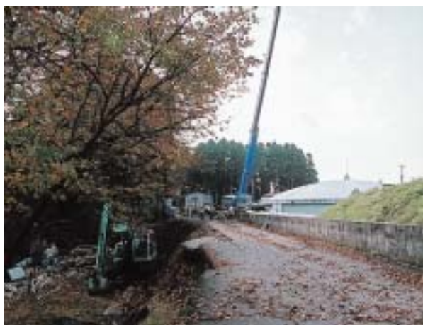
船岡山配水池も被害
