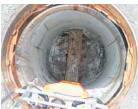
△油で詰まったマンホール内
