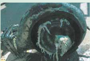
△タオルが絡まって停止した汚水ポンプ
